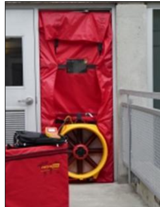
Fig. 2. Telo installato sulla porta d'ingresso dell'edificio
